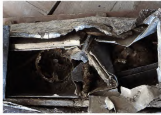
2 Nach Abnahme des Deckblechs. Links Kammer A mit beschädigtem Innenblech, rechts Kammer B ohne Innenblech und mit eingebrochenen Steinen.
