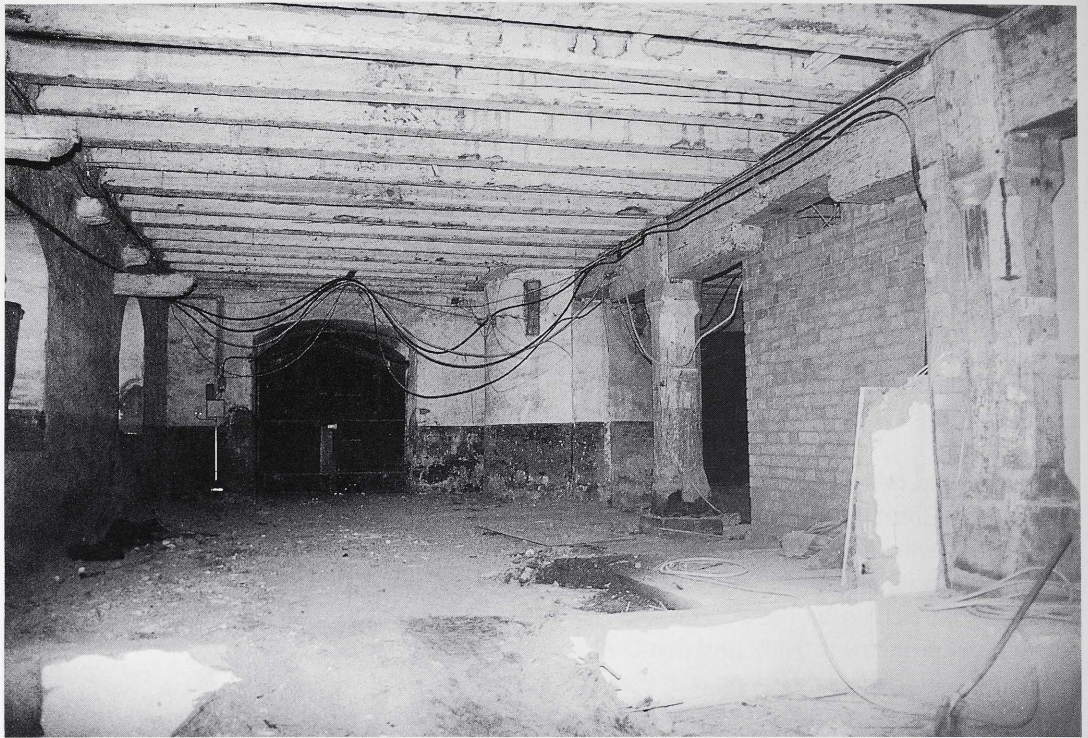
Abb. 18: Überlingen, Greth. Erdgeschoß der östlichen Gebäudehälfte, Blick nach Norden mit dem mittelalterlichen Deckengebälk und der mittelalterlichen Stützenachse (rechts).
