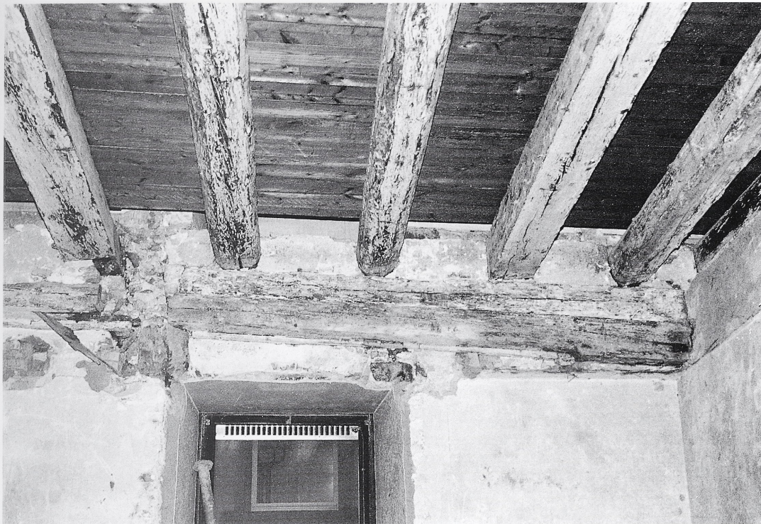
Abb. 20: Überlingen, Greth. Deckenbalkenaufleger am südlichen Ende der Ostwand des Erdgeschosses der östlichen Gebäudehälfte. Der mittelalterliche Streichbalken ist bei einer Bewegung des Gebäudes nach unten abgesunken. Beim Barockumbau wurde das Deckengebälk angehoben und mit einem weiteren Balken unterfüttert.
