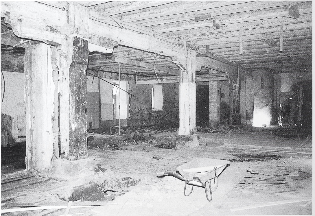
Abb. 22: Überlingen, Greth. Blick in die Erdgeschoßhalle der westlichen Gebäudehälfte mit barockem Tragwerk.
