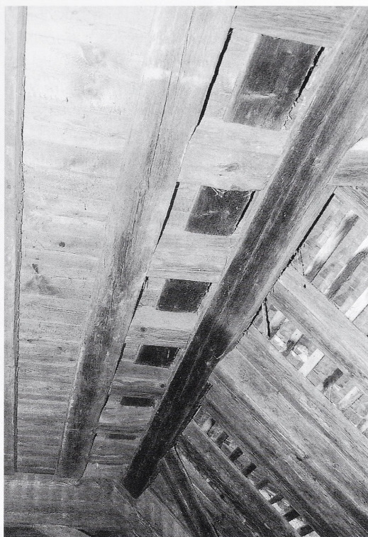
Abb. 33: Überlingen, Greth. Von Anfang an vorgehene und regelgerecht ausgeführte Stichgebälkausbildung an der Ostseite des ersten Dachgeschosses.
