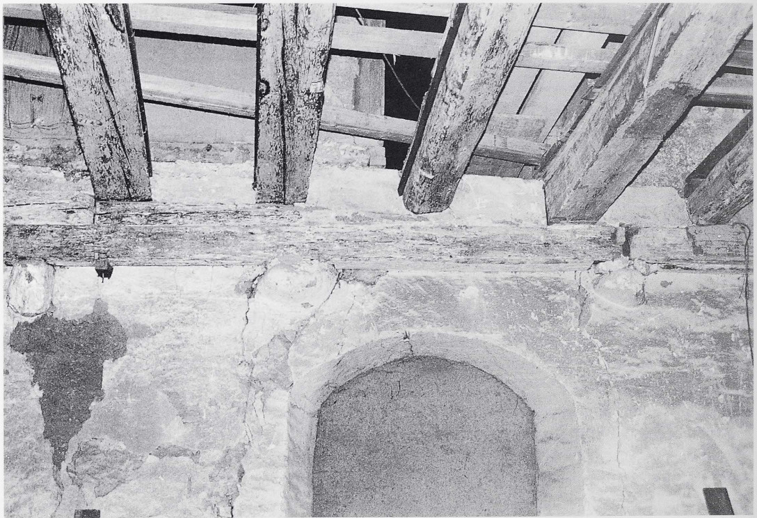
Abb. 19: Überlingen, Greth. Deckenbalkenaufleger des 14. Jahrhunderts an der Mittelwand des Erdgeschosses der östlichen Gebäudehälfte.
