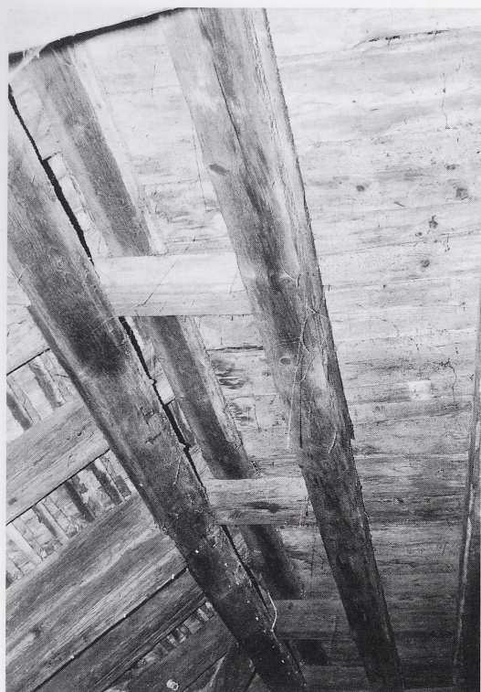
Abb. 32: Überlingen, Greth. Auf nachträglicher Abänderung beruhende, nicht regelgerechte Stichgebälkausbildung an der Westseite des ersten Dachgeschosses.
