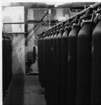
Bild 3: Die CO 2 -Flaschen sind in Batterien zusammengefasst.
