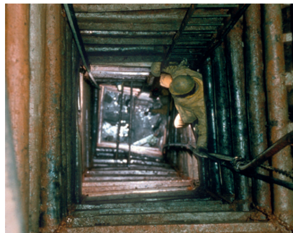
Abb. 6 Schacht 1 des Altenbergs bei Müsen (Liste 2, 34) wurde in die Tiefe verfolgt, indem ein neuer Schacht um den mittelalterlichen herum abgeteuft wurde. So konnte der mittelalterliche Holzbausbau Stück für Stück geborgen werden (Foto: Deutsches Bergbau-Museum Bochum).
