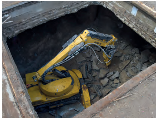
1 Köln-Altstadt-Nord, Archäologische Zone. Die Zertrümmerung der Sauberkeitsschicht unter der Betondecke mit einem kleinen Baggerroboter.
