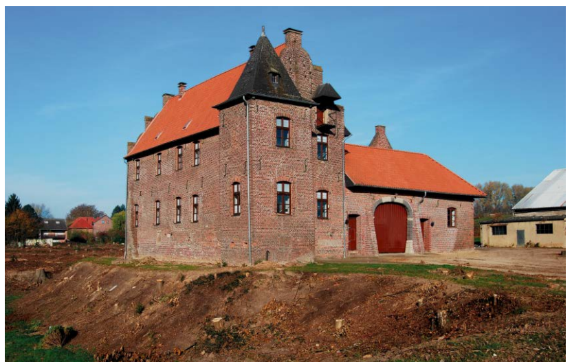
1 Erkelenz-Borschemich, Haus Palant. Das von Bewuchs freigestellte Herrenhaus Anfang November 2015 kurz vor dem Abbruch.
