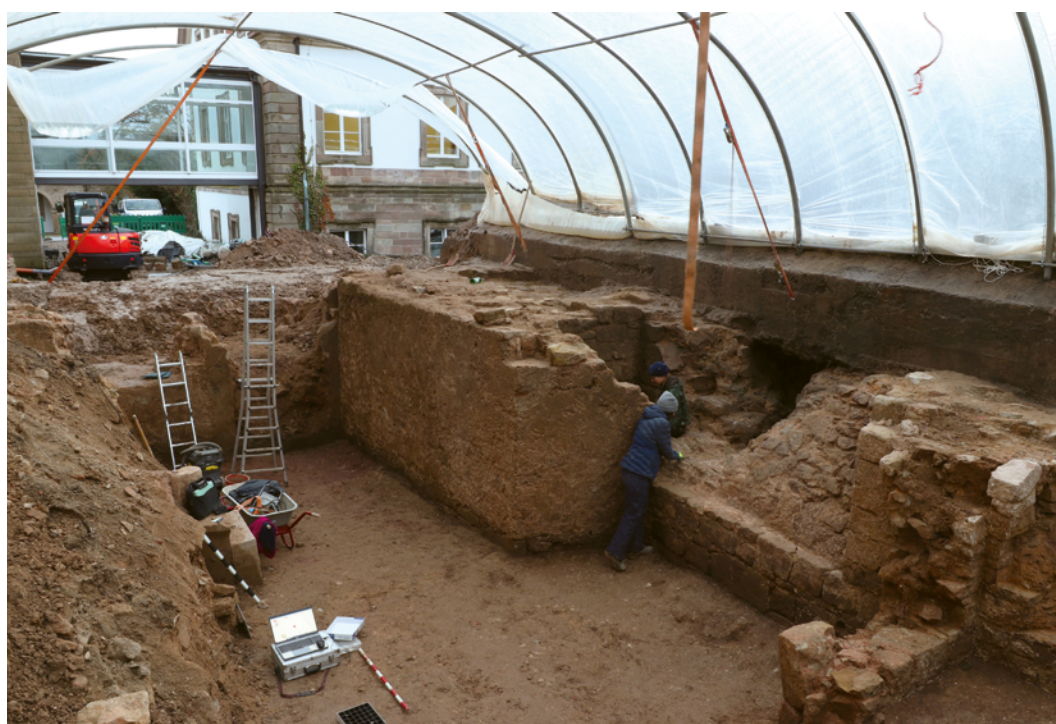
Abb. 3 Blick von innen auf die Ende des 17. Jahrhunderts massiv verstärkte Außenwand des Westflügels (Foto: LWL-Archäologie für Westfalen/W. Essling-Wintzer).
