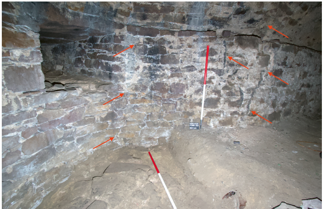
Abb. 4 Die Dehnungsrisse in den hinteren Seitenwänden des Kampfraums zeigen, dass der schwere vordere Bauwerksteil langsam in den Graben sackte (Foto: Stadtarchäologie Höxter/J. Müller-Kissing).
