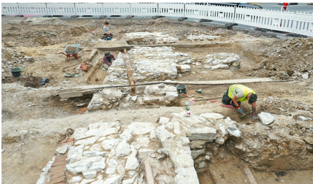
Abb. 3 Blick von Osten auf die Südwand der Bastion und auf die Querstreben (Foto: LWL-Archäologie für Westfalen/S. Gai).
