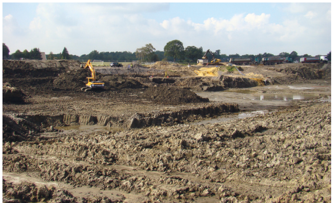
Abb. 1 Das Hochwasserrückhaltebecken während der Ausschachtungsarbeiten. Im Hintergrund an der Böschung ist die Fundstelle (markiert durch ein gelbes Vermessungsgerät) zu erkennen (Foto: LWL-Archäologie für Westfalen/J. Pape).
