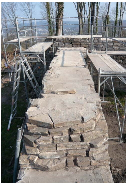
Abb. 2 Technische und inhaltliche Sanierungsfehler kennzeichnen das 1989–1992 auf älteren Fundamenten neu errichtete Mauerwerk der Rüdensburg. Dabei folgen die Neuaufmauerungen weitgehend den Fehlinterpretationen der Ausgrabung von 1929–1931. Hier ein Blick auf die moderne Mauerkrone der östlichen Binnenwand mit Schäden und gerundetem Abschluss (Foto: Büro für Burgenforschungen Dr. Zeune/ T. Starke).
