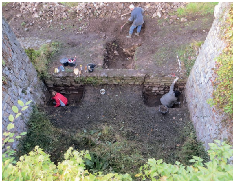
Abb. 4 Grabungsschnitte am Zusammenschluss von Ringmauer und Wohnturm; oben Schnitt S ID, unten links Schnitt S IB, unten rechts Schnitt S IA. Diese Schnitte sollten die Baustratigrafie von Turm und Ringmauer abklären. Sie zeigten deutlich, dass der Turm noch während des Baus der Ringmauer in einem zweiten Baulos hochgeführt wurde (Foto: Büro für Burgenforschung Dr. Zeune/T. Starke).
