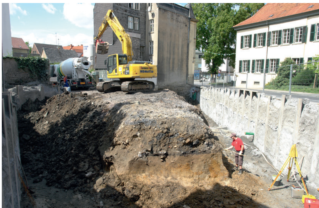
Abb. 1 So fand die Außenstelle Olpe am 19. August 2008 die Baustelle in der Werler Marktstraße vor, nachdem diese bereits zum Teil ausgekoffert worden war (Foto: LWL-Archäologie für Westfalen/H. Menne).
