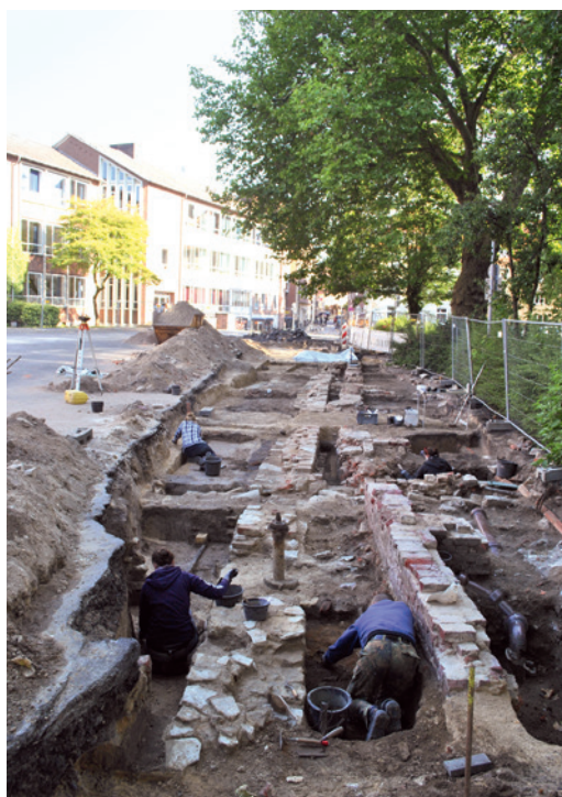
Abb. 6 Auf dem Schulhof der künftigen Gesamtschule Mitte kamen in Münster Baubefunde zutage, die zum Beginenhaus Hoffringe gehören sowie diverse ältere und jüngere Erdbefunde, die bis in das 10. Jahrhundert zurückreichen (Foto: Stadtarchäologie Münster/U. Holtfester).
