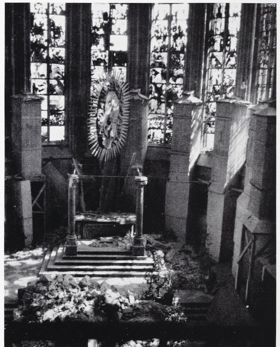
Abb. 4 Das Innere des Domchors in Aachen, Frühjahr 1944, nach den Zerstörungen des Bombenangriffs von Heiligabend 1943
