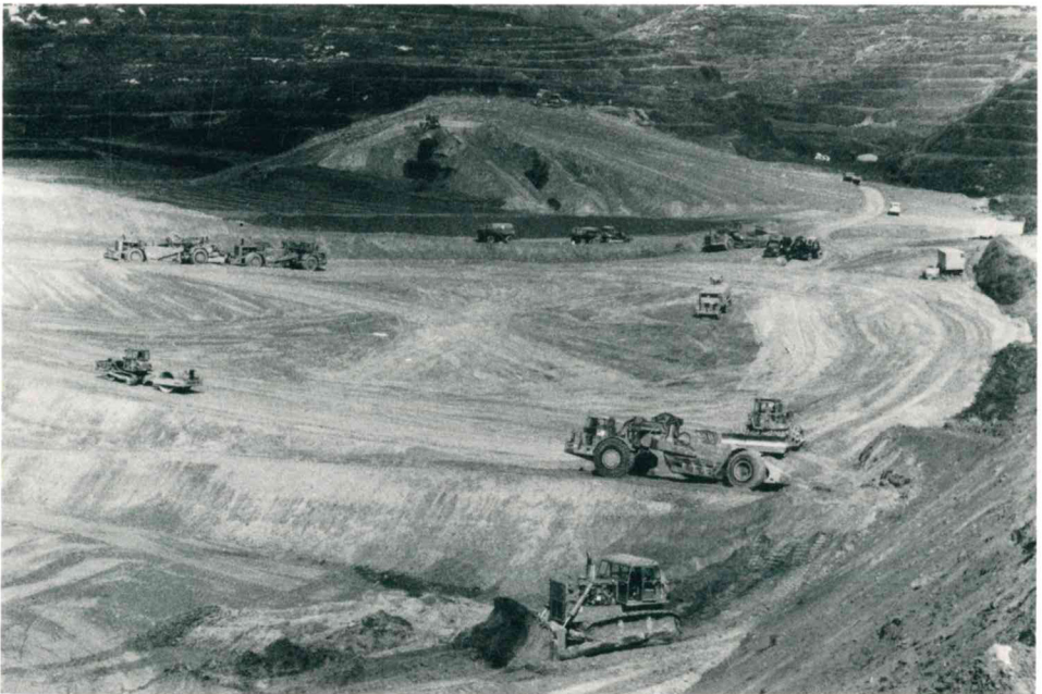
Abb. 3: Oberbergen, Stadt Vogtsburg, Kr. Breisgau-Hochschwarzwald. Blick von Süden in das laufende Verfahren zwischen Eck und Leh. Mit dem von den Höhenrücken abgetragenen Löss werden die kleinen Seitentälchen aufgefüllt.
