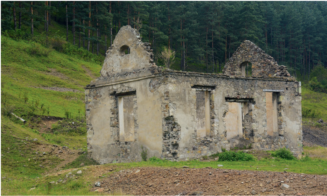
Abb. 4 Ruine des Stromkraftwerkes mit wassergetriebener Turbinenanlagen bei der Kalakenter Hütte. © Foto: M. Gruber.
