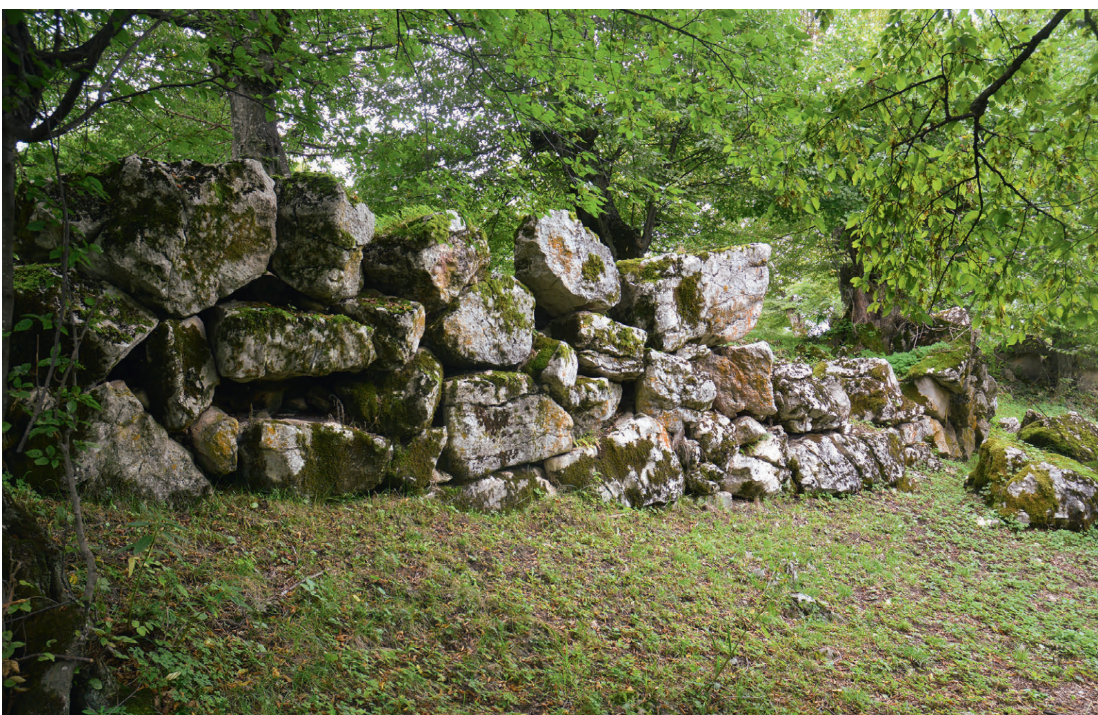
Abb. 11 Abschnitt einer aus großen Kalkblöcken errichteten Stützmauer im zentralen Bereich der Paradiesfestung. © Foto: M. Gruber.
