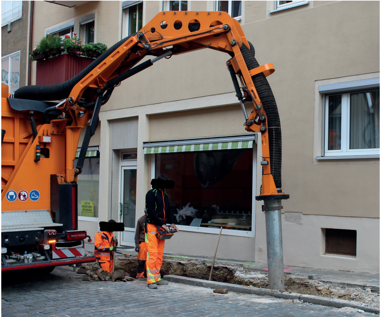
Abb. 3 Dieses Arbeitsfoto zeigt den Saugvorgang in einem Leitungsgraben (Sommer 2020). (Foto: B. Srock M.A., Kreuzschnitt GmbH).
