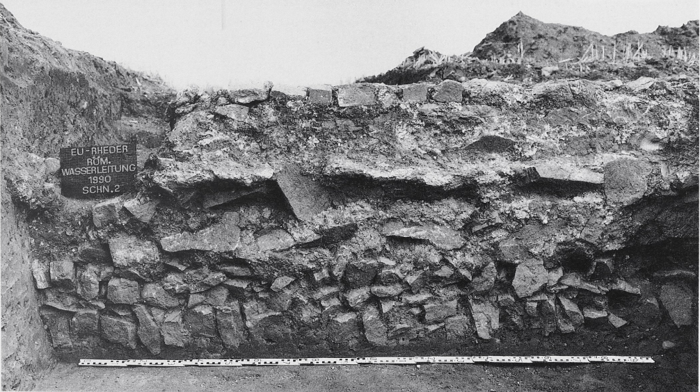
15 Euskirchen-Rheder (29.4). Die Leitungssubstruktion in Schnitt 2 von Süden: auf einer Stückerung aus losen Steinen sitzt ein gegen die Baugrubenwand gegossenes Paket aus Opus caementicium. Die oben sichtbare Reihe von gesetzten Handquadersteinen zeigt die unterste Lage des aufgehenden Mauerwerks.
