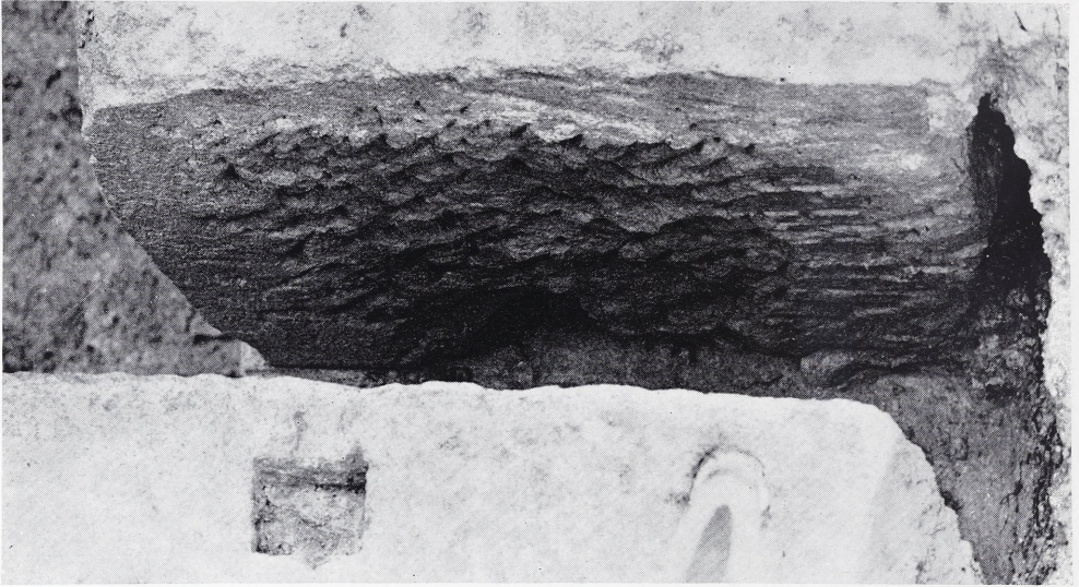
43 Die zwei oberen Sandsteinblöcke der Verkleidung von Pfeiler Nr. 5 (siehe Abb. 40), auseinander-geschoben. Die Randzonen der Stoßflächen sind eben bearbeitet, das Mittelfeld ist tiefer ausgehauen. Von Süden gesehen.
