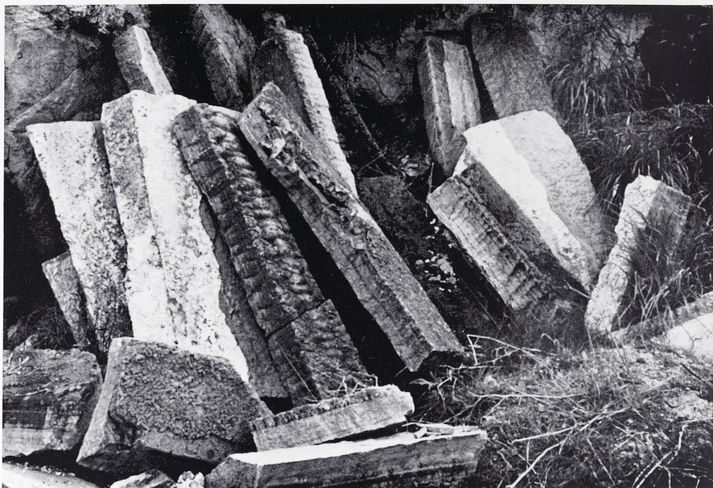
38 Sinterplatten aus der Leitungstrecke bei Breitenbenden (siehe Abb. 7) ausgebrochen.
