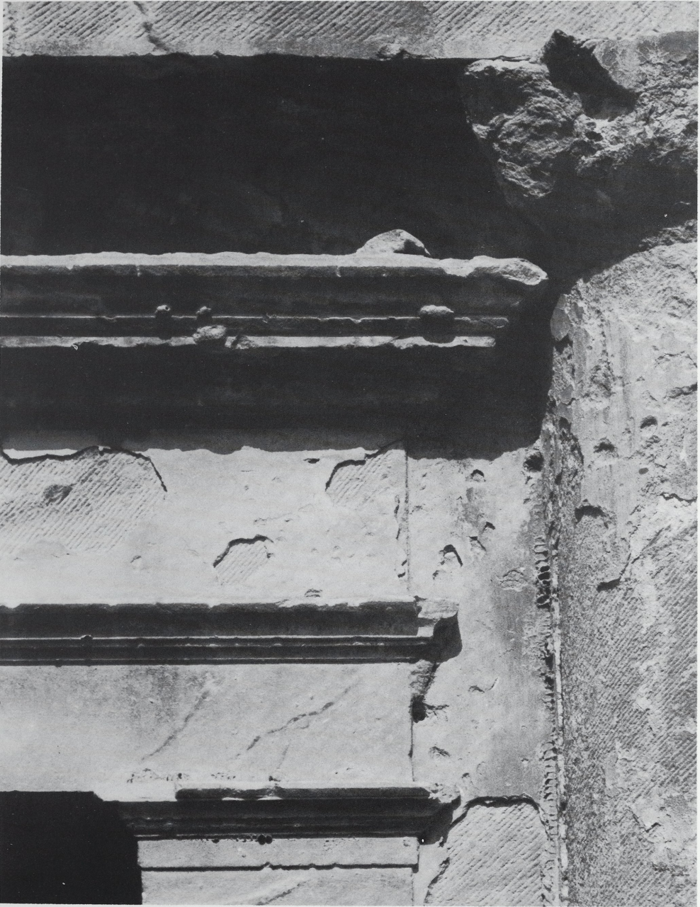
7 Stuckreste, Petra, Fassade 676.
