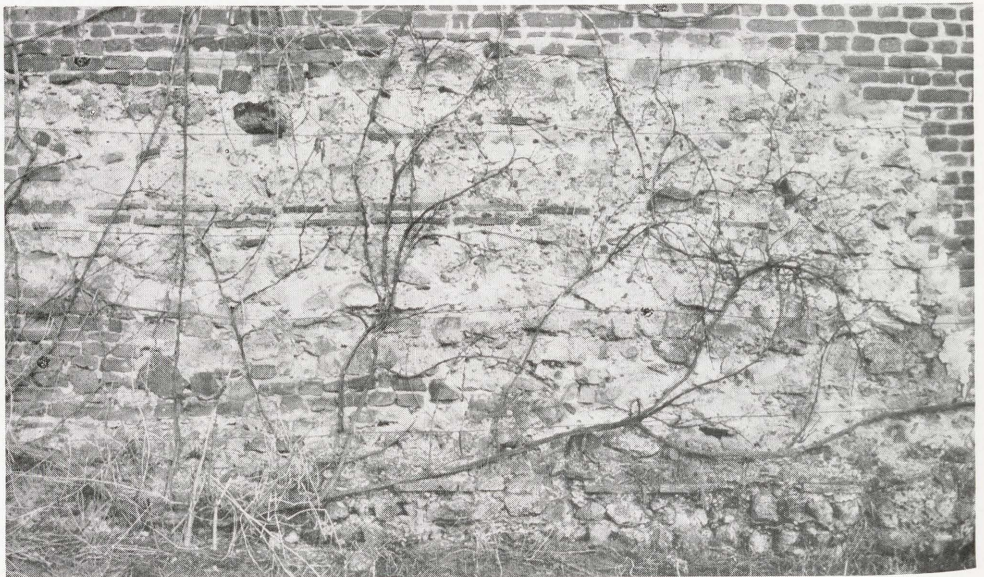
Abb. 2. Ostende der Südmauer, Außenseite. Unten zwei Lagen Tuffsteine, darauf Reste des zweiten Ziegelbandes (das erste verdeckt unter der Erde); 1,2 m darüber das dritte doppelte Ziegelband.
