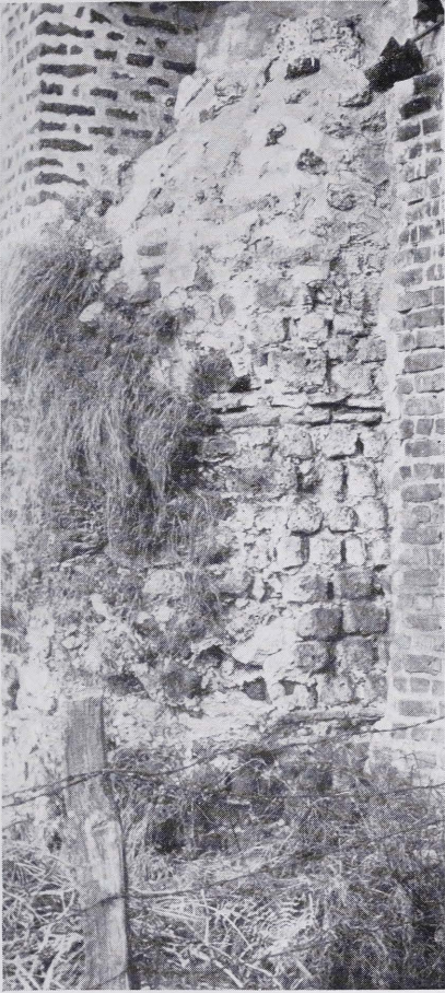
Abb. 1. Turmrest im westlichen Drittel der Südmauer von Südosten. Tuffquadermauerwerk mit zwei Ziegelbändern vom Turminnenraum.
