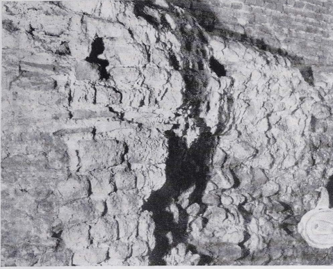
Abb. 1. Südostecke innen, Südmauer mit dem dritten Ziegelband und zwei Schichten Tuff, darüber die zweite Rüstlochreihe (3 Stück). Verblendung nur links noch erhalten.
