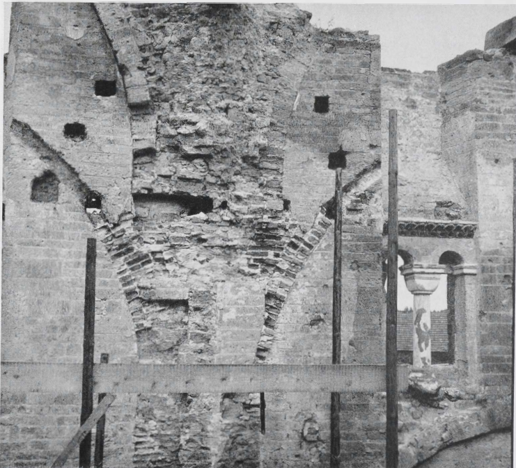
Abb. 2. Hochelthen. Gewölbezwickel zwischen dem 2. und 3. Joch von Westen in der Nordwand des Mittelschiffes; unten Ansatz des barocken Ziegelsteingewölbes, darüber romanischer Gewölbezwickel. Die Queröffnung an seinem Unterende ist die aufgebrochene Westhälfte-Holzbalkenverankerung am 5. Oktober 1956.
