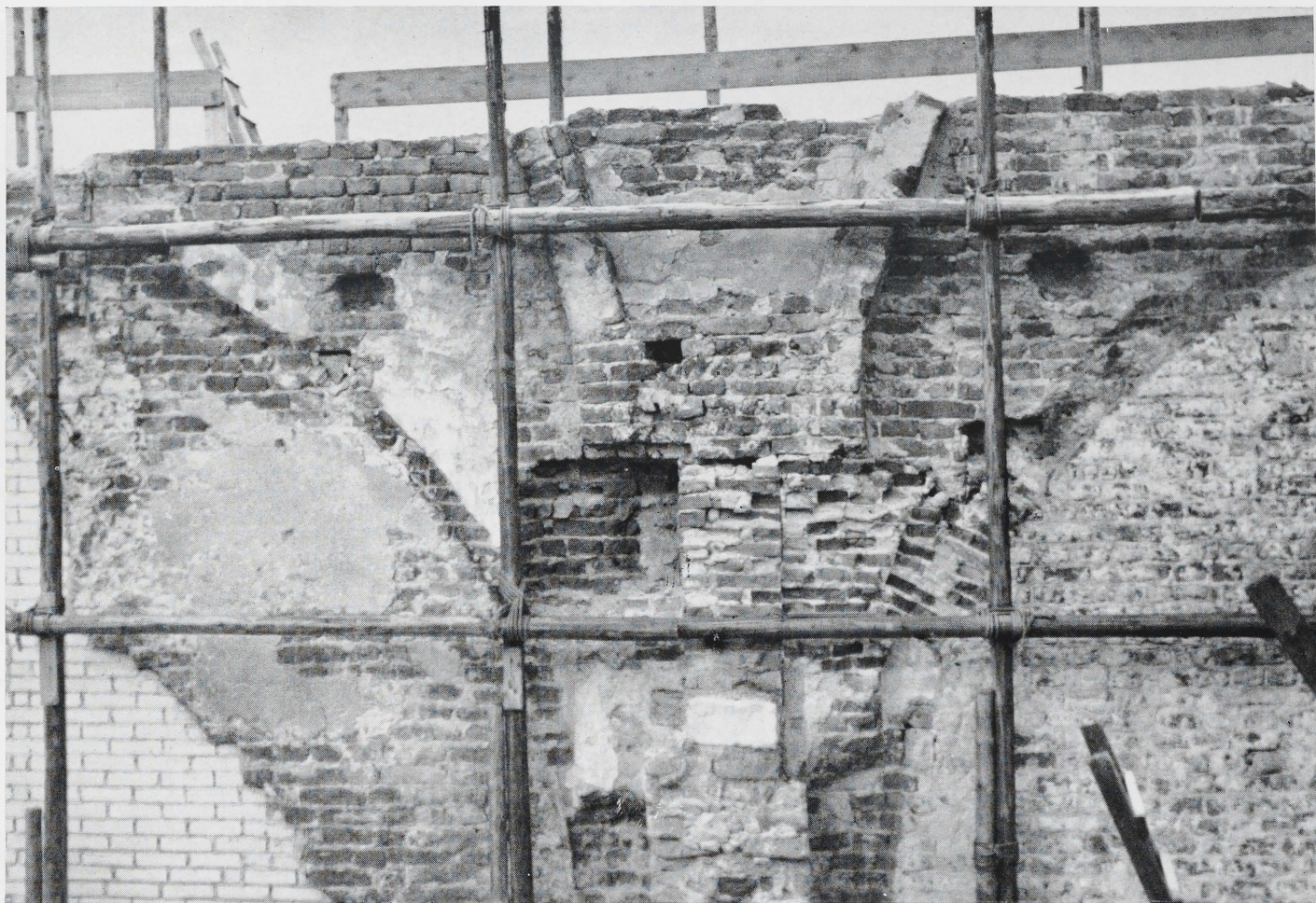
Hochelten. Gewölbezwickel zwischen dem 2. und 3. Joch von Westen in der Südwand des Mittelschiffes am 12. September 1957.
