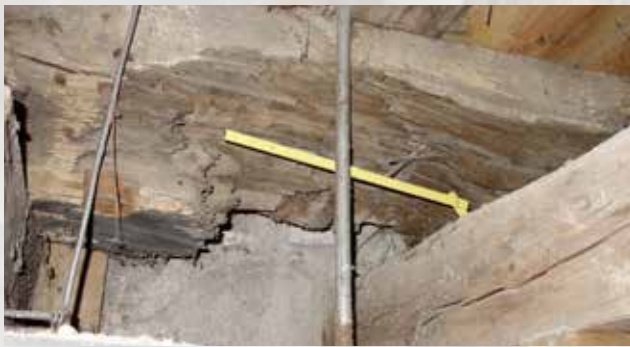
Der in Teilen noch mittelalterliche Glockenstuhl im Breisacher Münster muss dringend saniert werden
