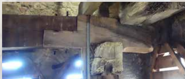
Statt Balken im gesamten zu ersetzen wurden bei der vorausgegangen Sanierung nur Teile eingesetzt.
