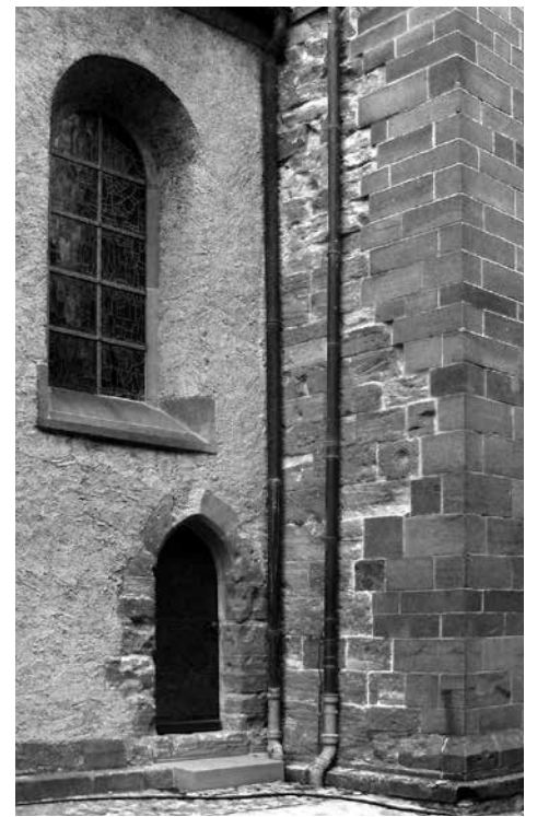
Abb. 1 Die in das südliche Seitenschiff führende Hasenpforte von außen (Aufnahme nach Wiederherstellung der Tür 2008) (Bilder 1 bis 4 F. Löbbecke)
