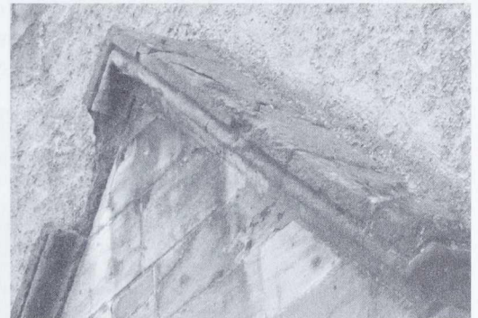
Schäden am Äußeren des Breisacher Münsters sind eher die Normalität (hier Giebelgesims des linken Nordeingangs)
