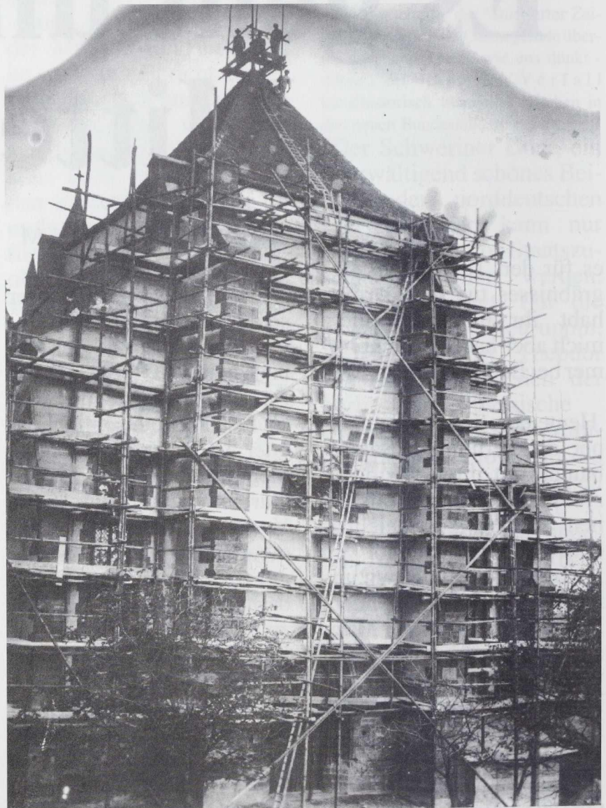
Außenrenovation am Westbau des St. Stephansmünsters um 1924. Die langen Leitern treten als diagonale Linien von links unten nach rechts oben hervor. Auf der zur Dachspitze laufenden Leiter sitzt, kaum erkennbar, Gervas Haury. Rechts von ihm steht vermutlich Ferdinand Wehrle. Die Namen der drei Handwerker ganz oben auf dem kleinen Gerüst konnten nicht ermittelt werden.
