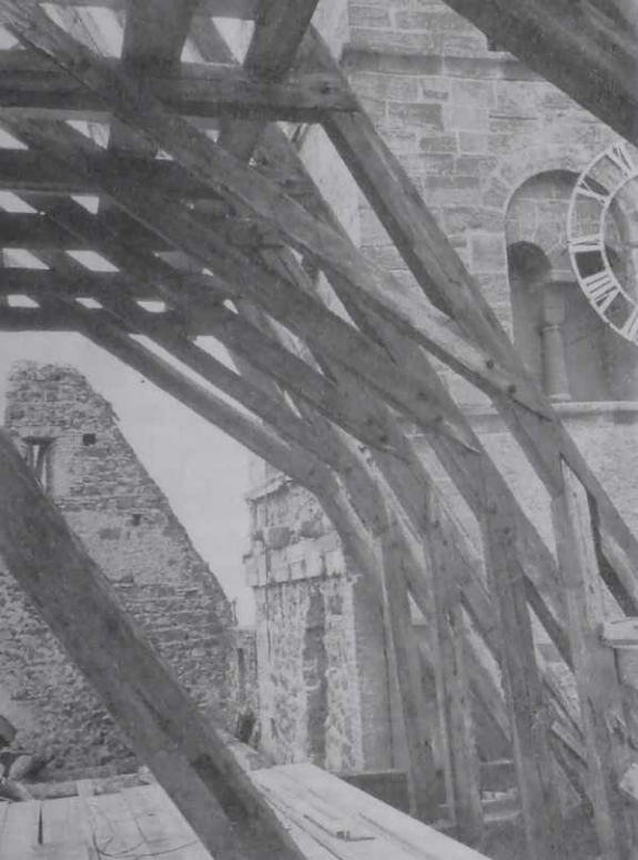
Abb. 1 und 2 (unten): Historische Fotografien des Chordachs nach den Zerstörungen 1944/45 (Vorlagen: Stadtarchiv Breisach)
