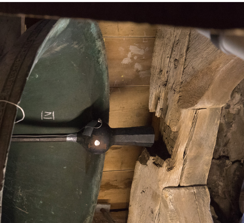
Das Gebälk wurde an dieser Stelle ausgespart, um Platz für den schwingenden Klöppel zu schaffen.
