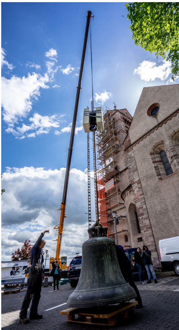
26. April 2018 - Herabnahme der vier historischen Glocken aus dem Nordturm durch Firma Schneider, im Bild die Glocke "Tuba Dei"
