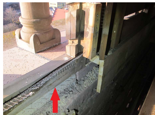
Schadstelle Innenseiten der Schallläden
