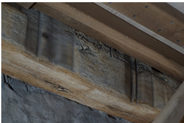
Abb. 6: Südflanke des nördlichen Balkens mit tief eingegrabener Abreibung durch Glockenseile.
