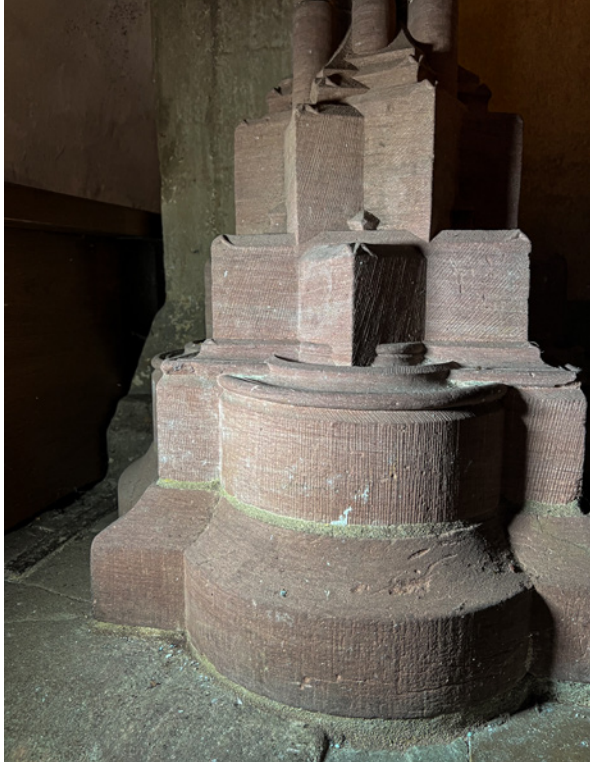
Abb. 4: Der Sockel des Fußes aus rotem Sandstein setzt sich aus zwei Werkstücken zusammen, die mit einer Zementmörtelfuge verbunden sind. Der obere Teil ist ergänzt, was sich an der Steinbearbeitung sehen lässt. © Hans Leisen
