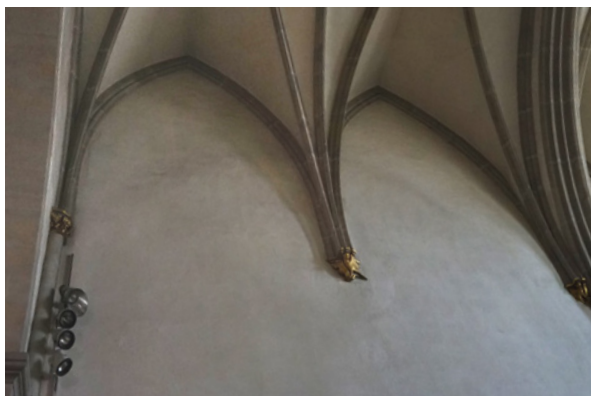
Abb. 7a: Nördliche Chorwand mit dunkler Schmutzablagerung als Ausbruchspur des Schildbogens eines früheren Chorgewölbes in der Form eines gedrückten Spitzbogens.
