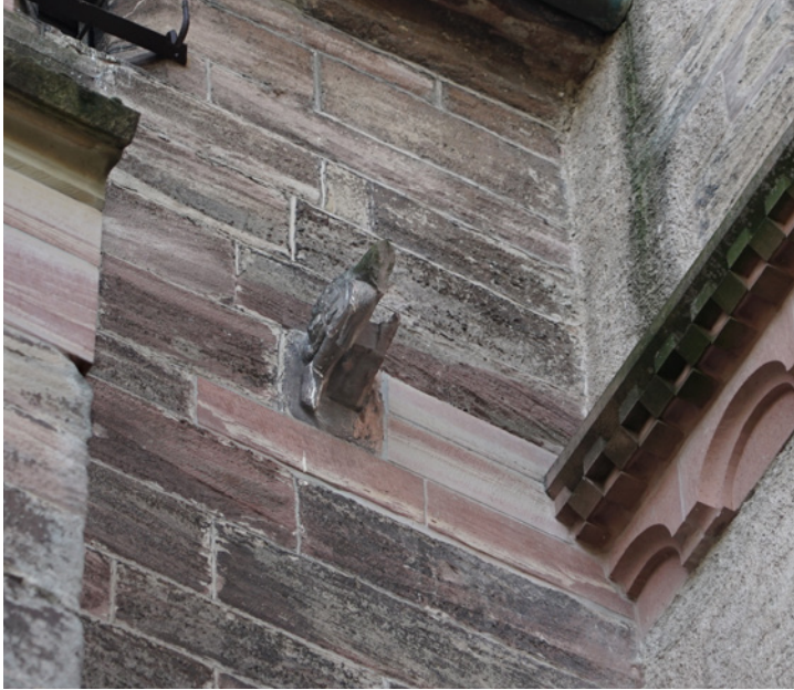
Abb. 8: Wasserspeier östlich des Nordturms in Höhe der dendrodatierten Balkenlage, der einst aus einer Steinrinne am Anschluss des früheren Chordachs an den Turm gespeist wurde. Große Teile sind abgebrochen und es ist nur ein Bein einer hockenden Figur übrig geblieben.
