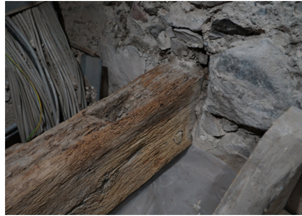
Abb. 5: Ostende des nördlichen Balkens während der Baumaßnahme von oben besehen: oberseitig ein Zapfenloch mit schräg verlaufenden Schmalseiten und horizontaler Holzdübel.
