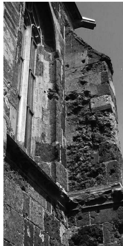
Sakristieanbau mit stark geschädigten Sand- und Tuffsteinen. Das Bild wurde 2004 aufgenommen
