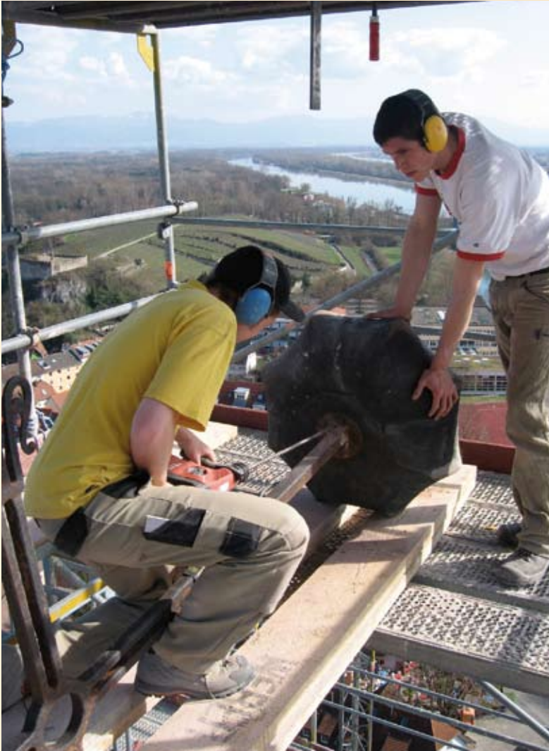
Südturm: Das in die Turmkugel eingeleite Kreuz wird mühsam aus dem Stein herausgebohrt (links Paul Ahl, rechts Philliph Adam, Steinmetze der Firma Hellstern)
