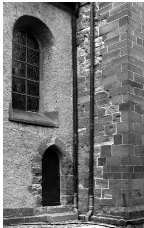
Abb. 1 Die in das südliche Seitenschiff führende Hasenpforte von außen (Aufnahme nach Wiederherstellung der Tür 2008) (Bilder 1 bis 4 F. Löbbecke)
