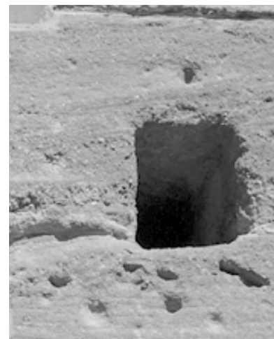
In der Umgebung des Westportals gibt es zwei etwa 12 x 12 cm große und bis 40 cm tiefe Löcher im Mauerwerk. Sie könnten Lagerlöcher für die Stützbalken des Vordaches gewesen sein.
