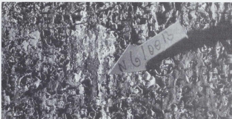
Makroaufnahme Nordwand: Krallen eines Teufels. Durch Fixiermittel und Übermalung von 1931 sich auflösende und abblätternde Malschicht.
