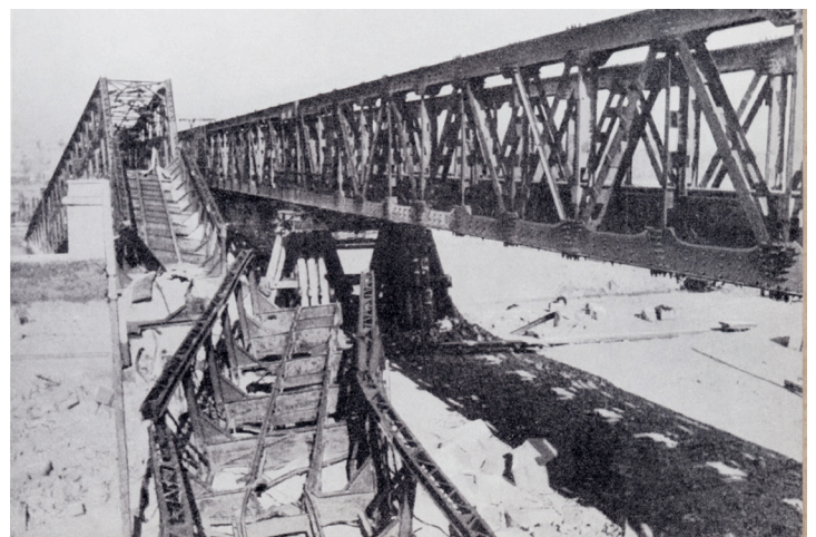
Zerstörte Eisenbahnbrücke. Bild Hermann Fuss, Freiburg
