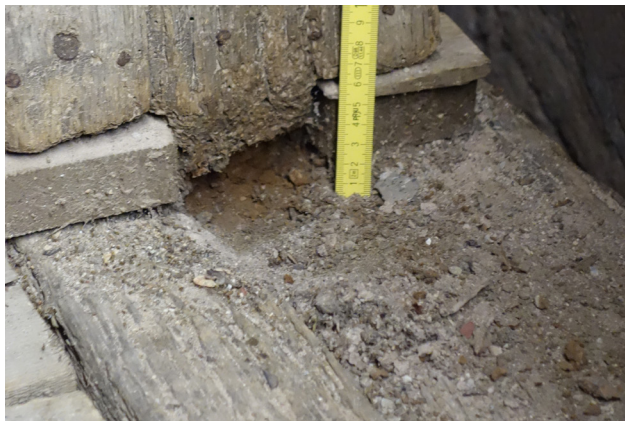
Bild 1: Schwelle mit starker Kernfäule
