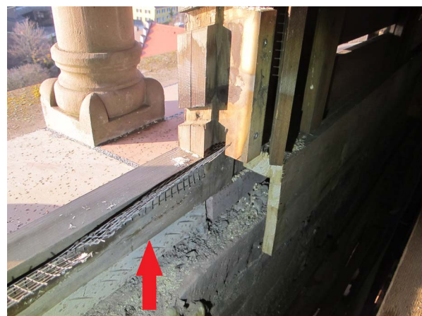
Schadstelle Innenseiten der Schallläden
