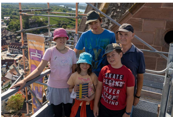
Peter Wiedensohler zeigt seinen Enkelkindern Tabea, Mara, Jakob und Carlos die Baustelle auf dem Nordturm
