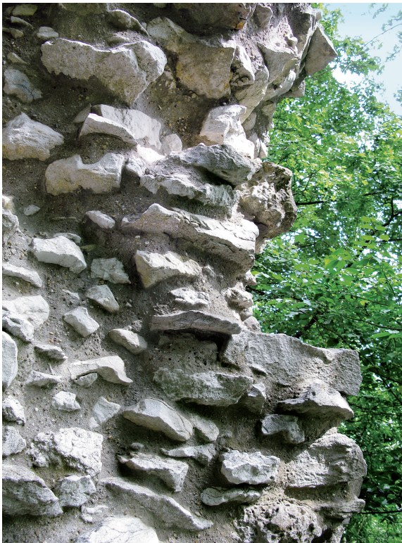
Abb. 2. Beispiel für kleingehaltene Mörtelflächen: Auf halber Höhe links im Bild gehören die kleinen hellen Steine nicht zum ursprünglichen Mauerwerk. Objekt: Obere Diepoldsburg/Kreis Esslingen am Neckar. Ausführung 1985: Planung und Bauleitung Verf. (Foto: Verf., 2009).
