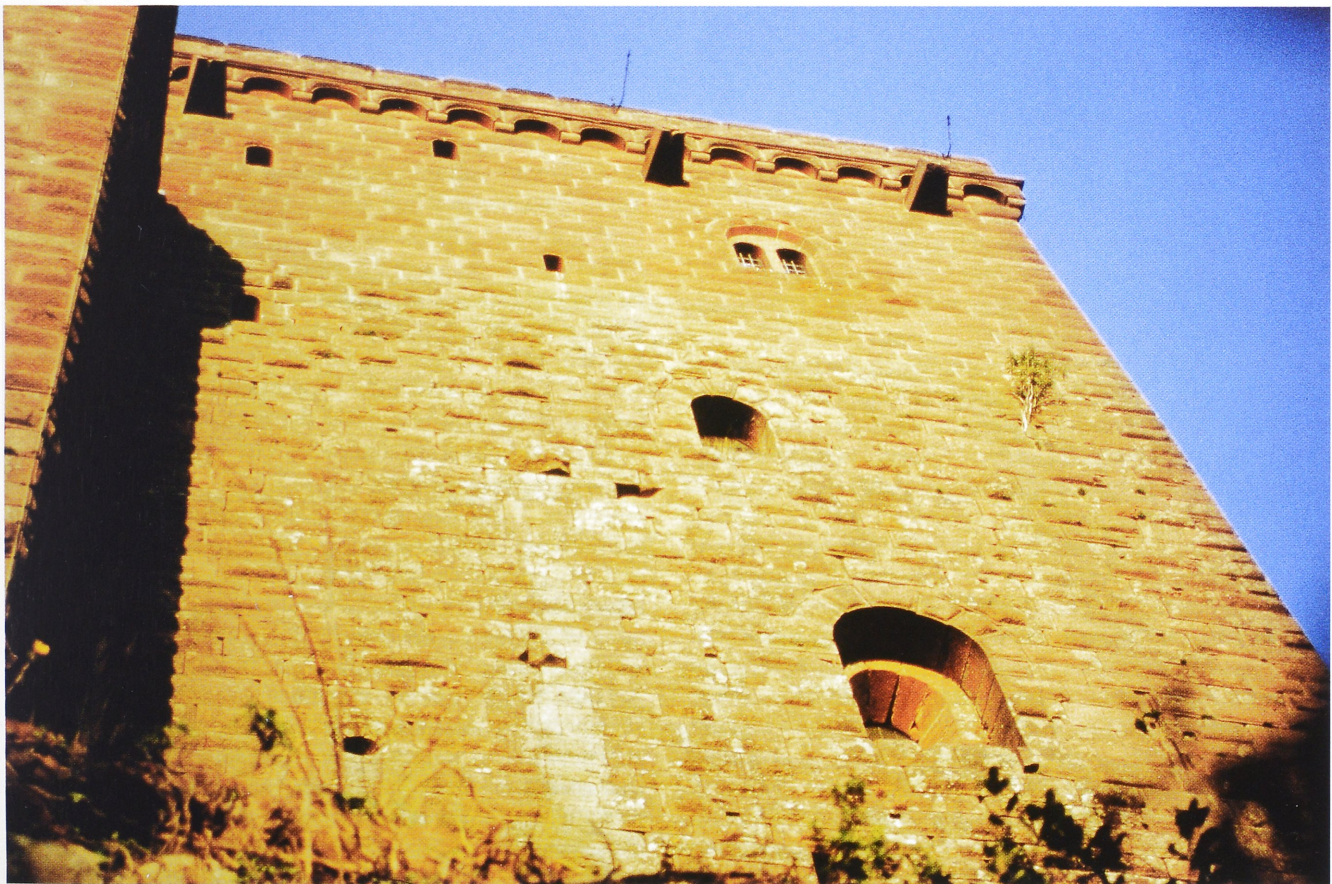
Abb. 13. Die Westseite des Kapellenturmes. Das ursprüngliche Mauerwerk ist durch den Farbunterschied von dem erneuerten abgesetzt. Der helle Farbstreifen und der Rest eines Quaders markieren den Platz eines Aborterkers (Foto: Verf.).
