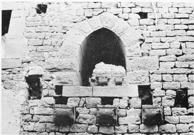
Abb. 16. Rathausmaison, Heizungsanlage im 1. Obergeschoß, Außenseite (Foto: Verf.)
