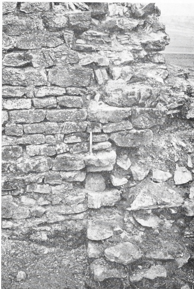
Abb. 1. Ruine Stein. Mauerfuge an der Nordmauer
