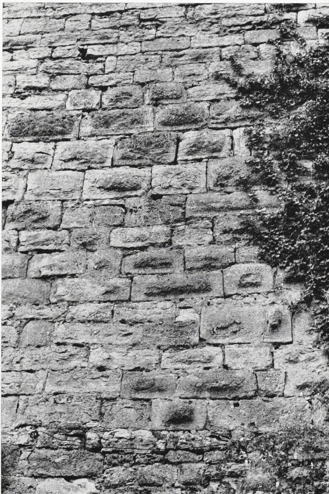
Abb. 9. Schildmauer, Mauerwerk der Außenseite über dem Tor. Ganz unten der obere Absatz, unten rechts der „Trutzkopf“
