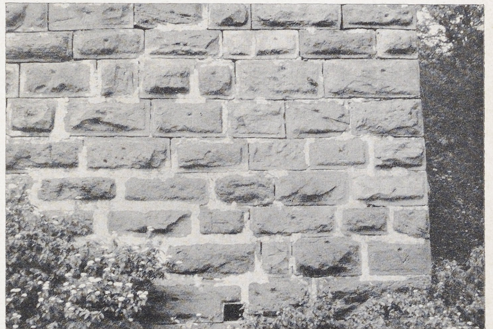
Abb. 6 Burg Freudenberg. Mauerwerk des 1. Aufsatzes mit Steinmetzzeichen und Gerüstloch (unten, Mitte), um 1200.
