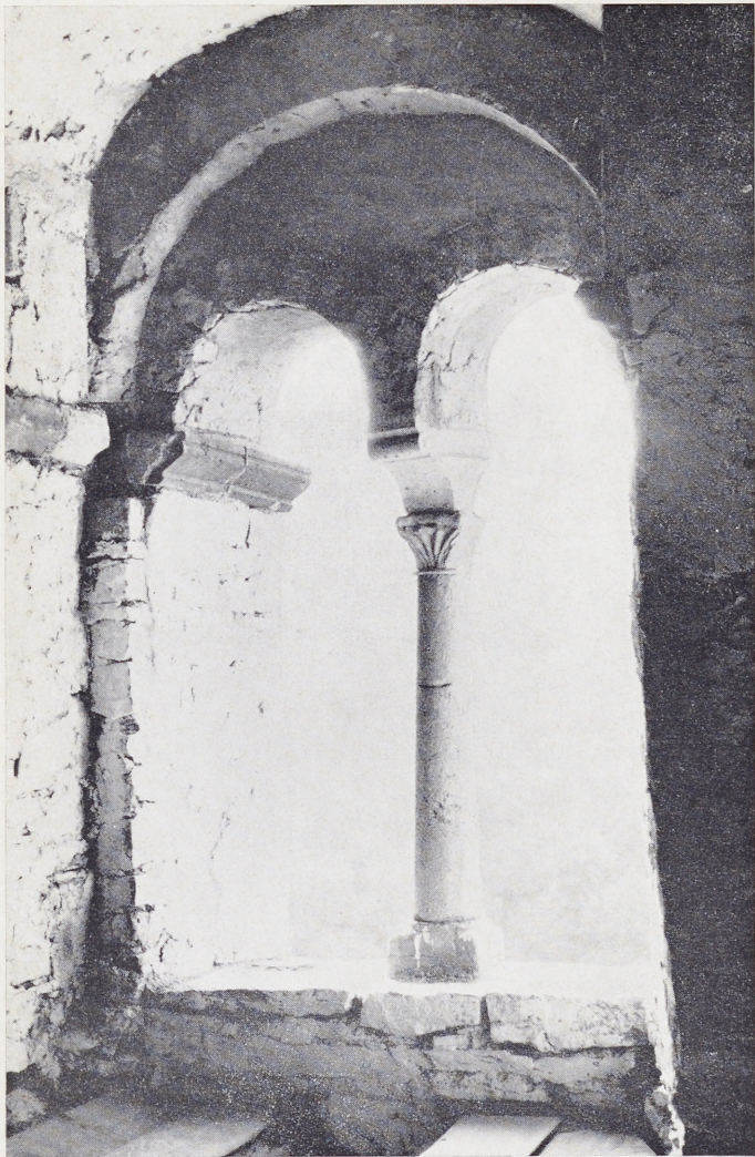
Abb. 14 Burgruine Neuerburg , linkes Saalfenster nach der Wiederherstellung 1965
