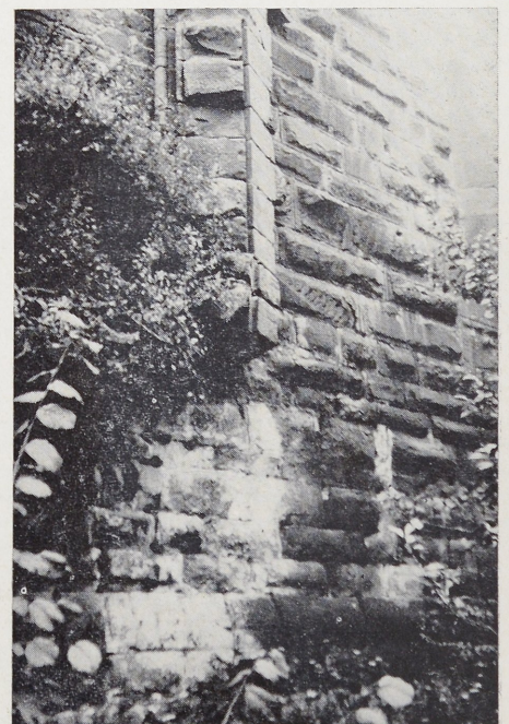
Biebelried. Außenmauern mit Resten des Kapellenwerkes. Die frühgotischen Buckelquader sind von Jauche zerfressen.
