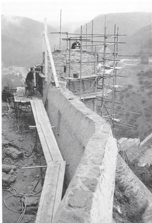
Abb. 2. Marksburg, Braubach. Restaurierung des östlichen Schalenturms im äußeren Zwinger 1987. (Foto: E. Schröder).
