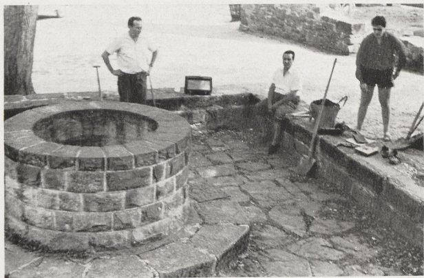
Abb. 2 Zisterne auf Burg Landeck (Pfalz). Brüstung und Einfassung wieder erneuert
