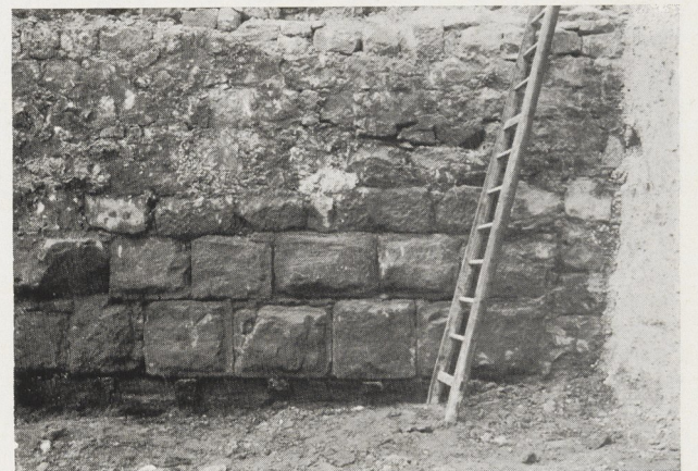
Abb. 17 Burg Lahr. Ufermauer des Burggrabens. Die Bossenquader ruhen auf einem durchlaufenden Eichenbalkenrost (1969)
