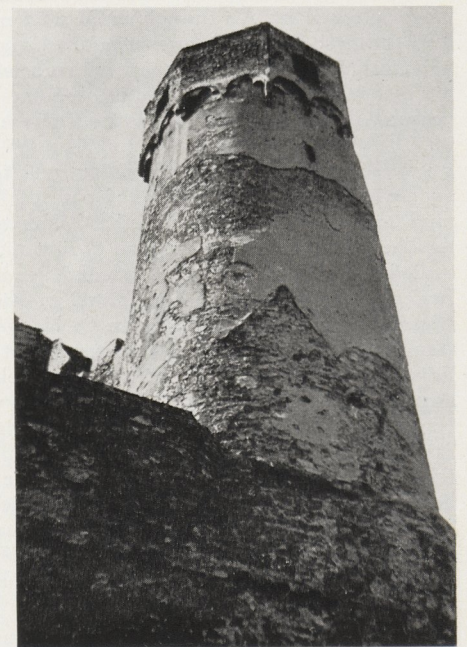
Abb. 6 Ruine Ehrenfels: Ostturm – Ostseite mit asymmetrisch aufgesetztem Achteckaufsatz und deutlich erkennbarem Dachansatzstreifen im Putz
