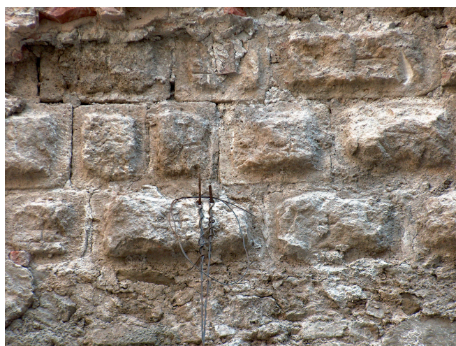
Abb. 7. Hofburg Wien, Details der Südwestfassade der Kernburg mit freigelegten Buckelquadern (Fotos: Verf.).
